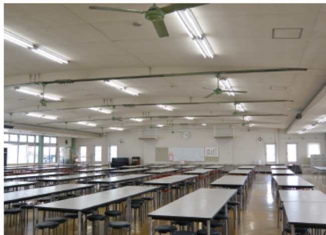
LED照明に取り替えられた食堂
