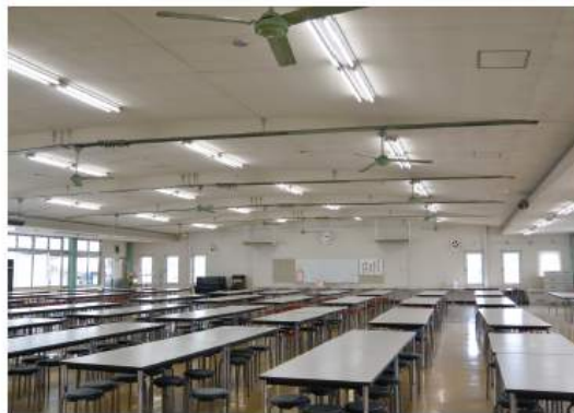
LED照明に取り替えられた食堂
